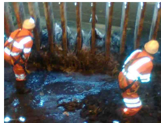
Rags blocking Detritor Inlet Vanes
